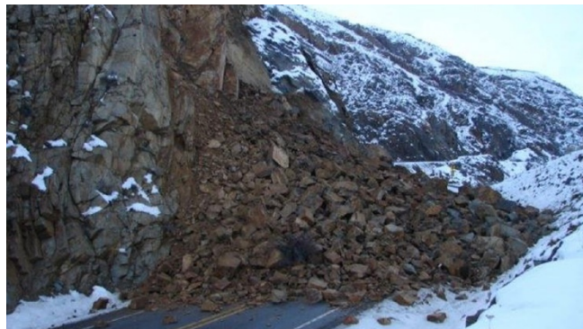
Rock Fall: Hwy 2, WA
